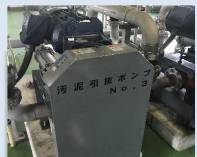
資産科目 機械及び装置 汚泥引抜ポンプ 耐用年数 20 年
